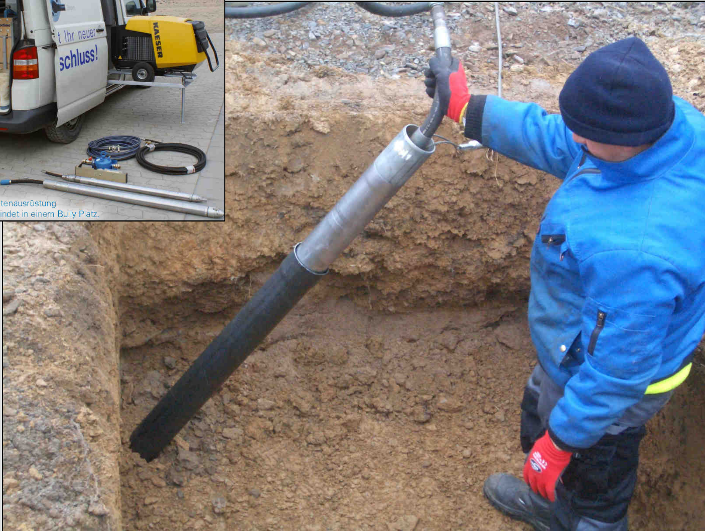
Erdwärme mit TT- Grundomat, Projekt VISSMANN
