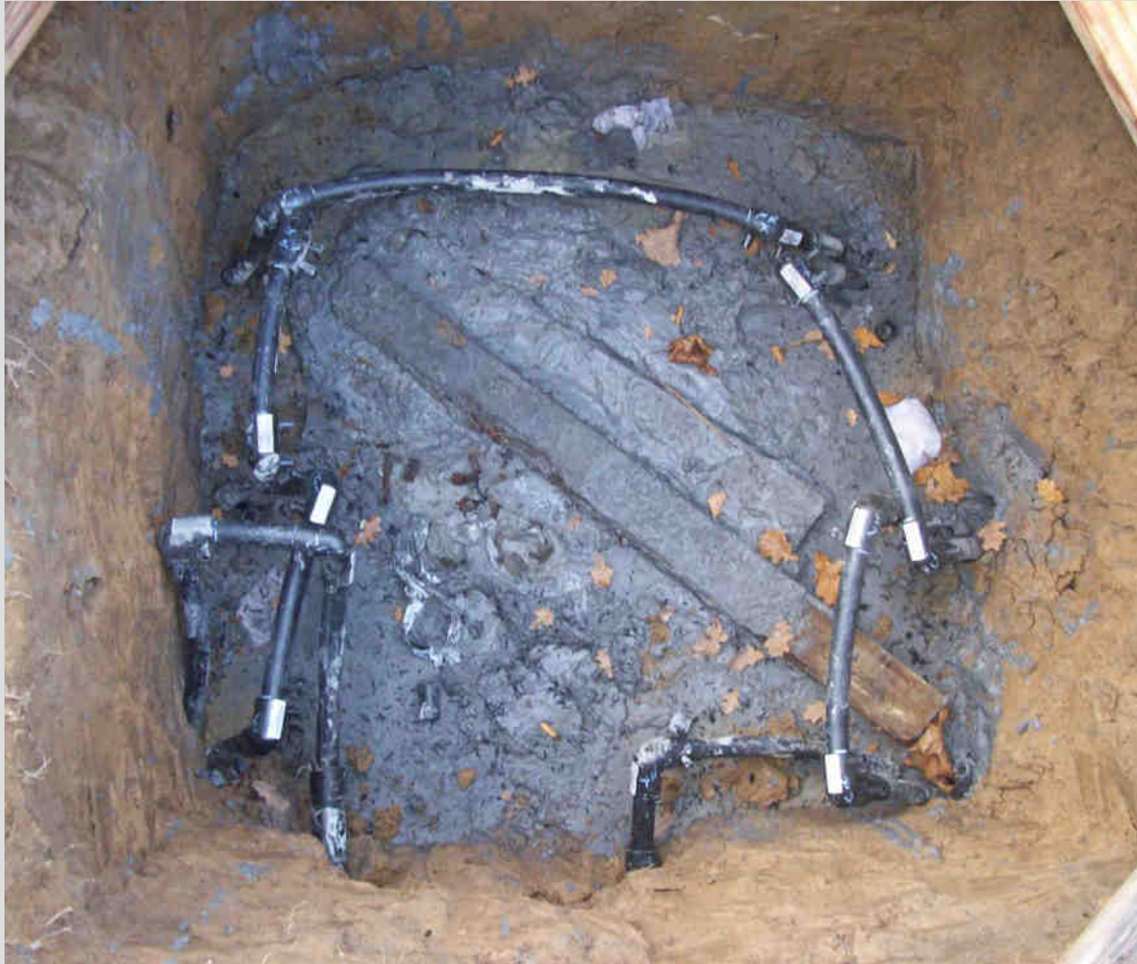
Erdwärme mit TT- Grundomat, Projekt VISSMANN
